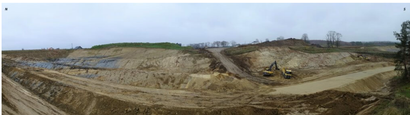
Rys. 5. Zdjęcie wykopu powstałego w trakcie budowy obwodnicy Nowego Miasta Lubawskiego, głębokość maksymalna 15 metrów, rozciągłość około 250 metrów.
